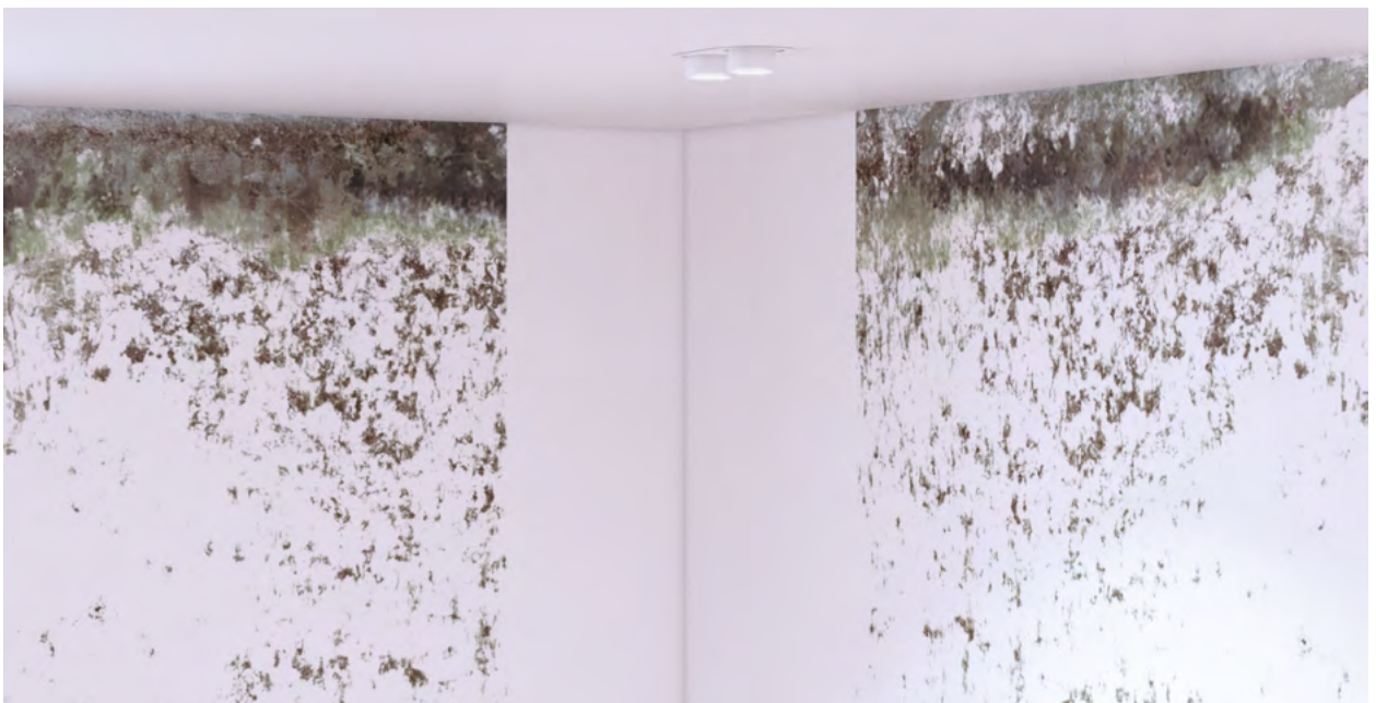
Der behandelte Bereich bleibt frei von Schimmel .
