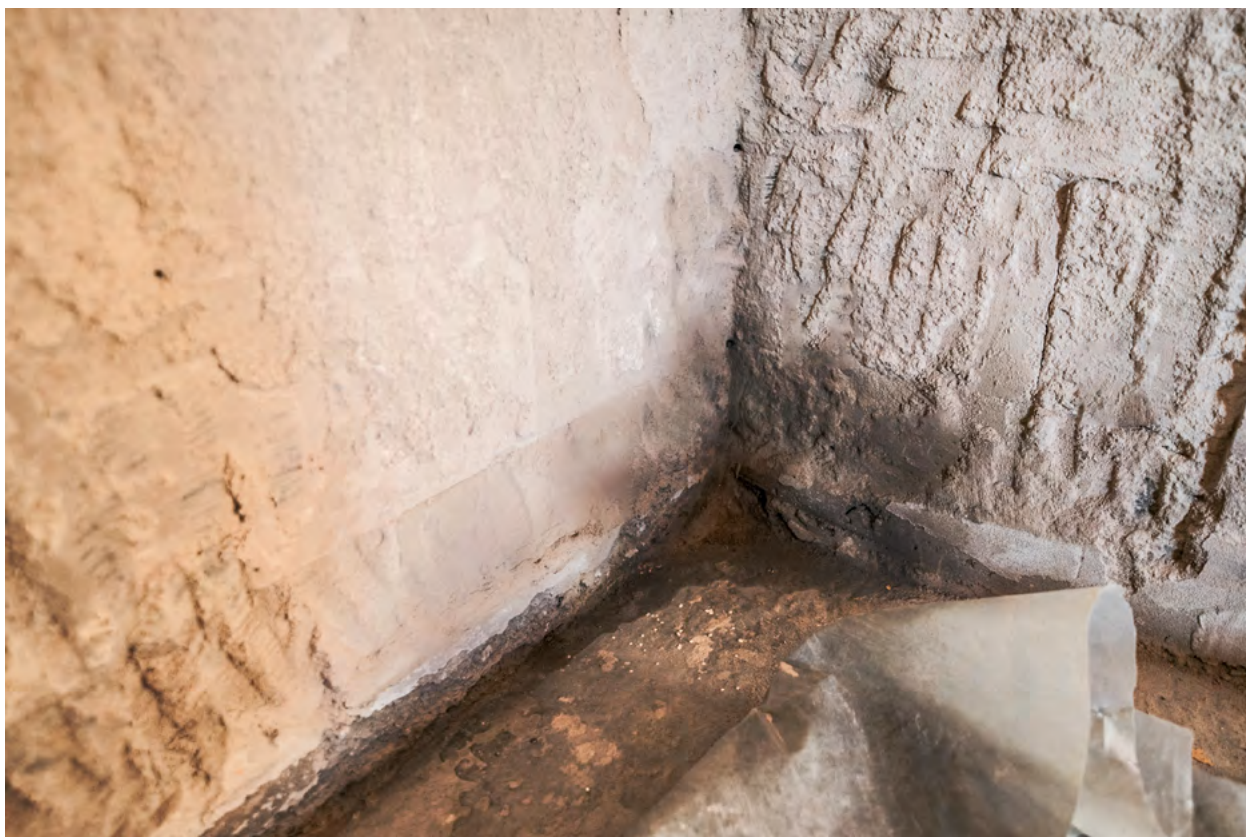
Wasser dringt in den Keller ein.
